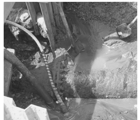
破損して漏水した水道管 この状態では安定した水の供給はできません
